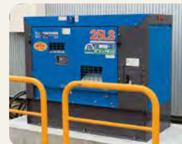
非常用発電機
