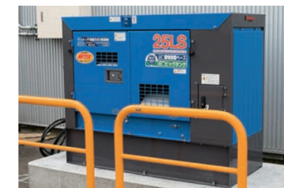
非常用発電機
