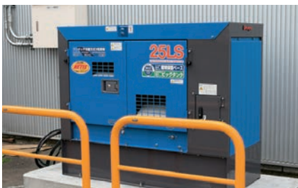
非常用発電機
